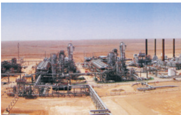
ガス生産基地、CCS設備(アルジェリア)
